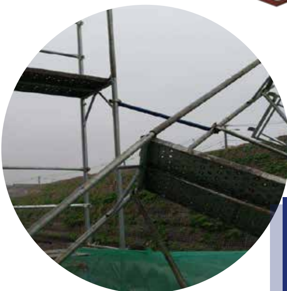
Imagen de un andamio mal estabilizado
