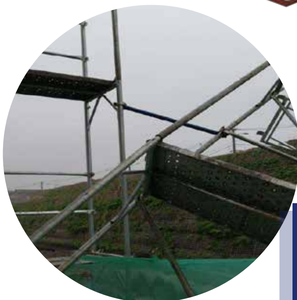
Imagen de un andamio mal estabilizado
