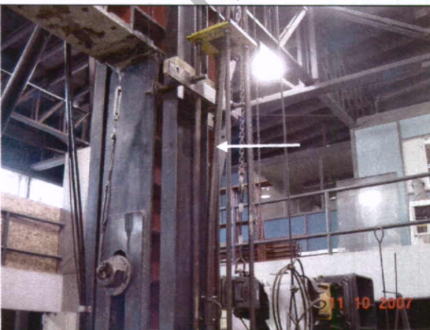
Fotografía 5: Detalle del pandeo global de la alzaprima (parte superior).
